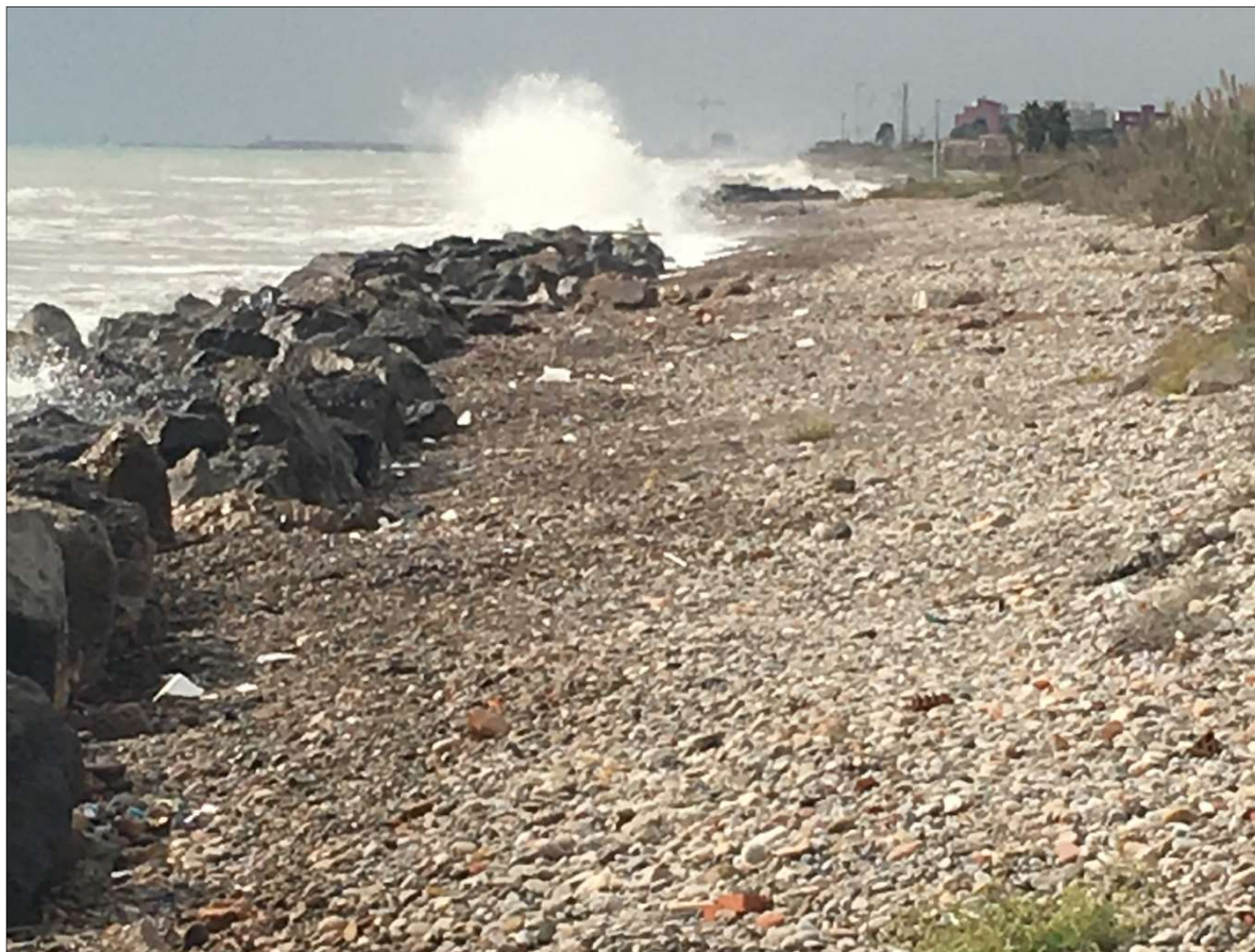
Figura 4. Estado actual de la escollera de protección
