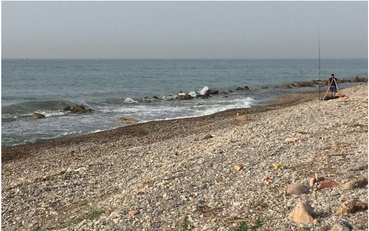
Figura 1. Estado actual de la escollera
