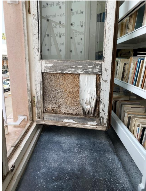
Fotografía del estado de las carpinterías. Fachada sur Fuente: El fabricante de esferas. 2021
