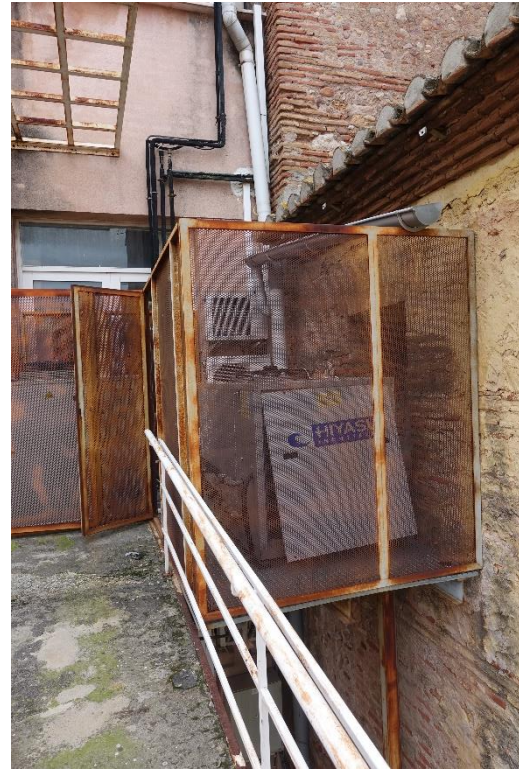
Detalle de la caja de instalaciones en la fachada norte Fuente: El fabricante de esferas. 2021
