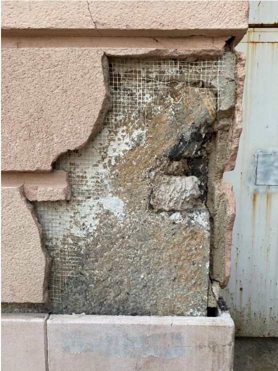
Fotografía detalle de la caída del revestimiento en la fachada Fuente: El fabricante de esferas. 2021
