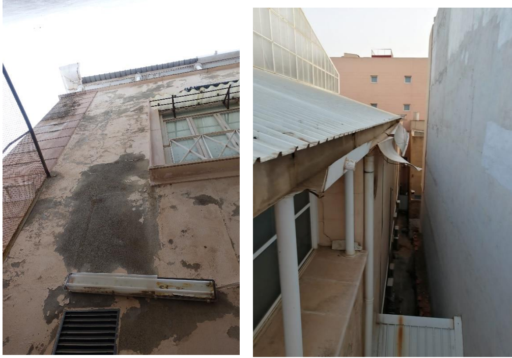
Fotografías de la rotura del canalón y consecuencias derivadas de él. Fuente: El fabricante de esferas. 2021
