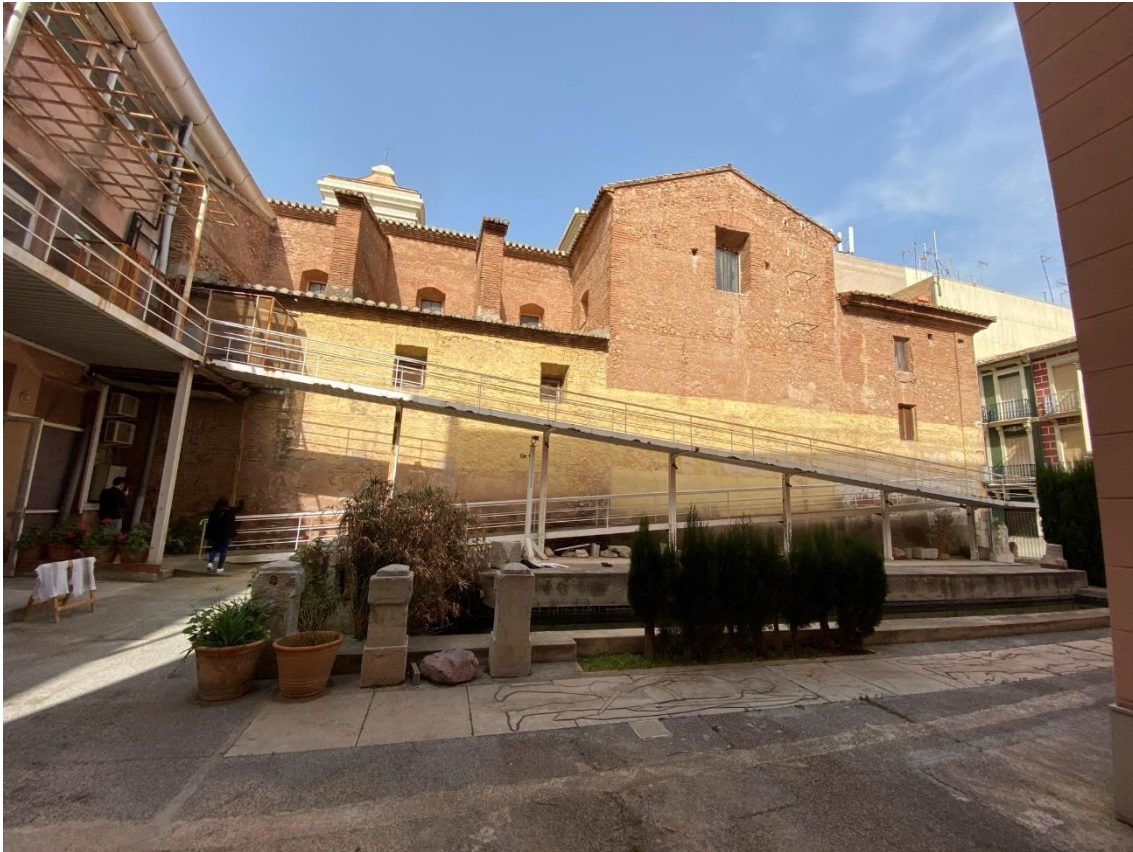
Fotografía del estado actual de la fachada iglesia y el corralot Fuente: El fabricante de esferas. 2021
