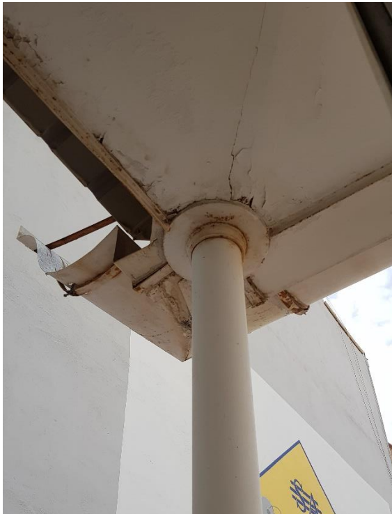
Fotografía detalle del estado del canalón Fuente: El fabricante de esferas. 2021
