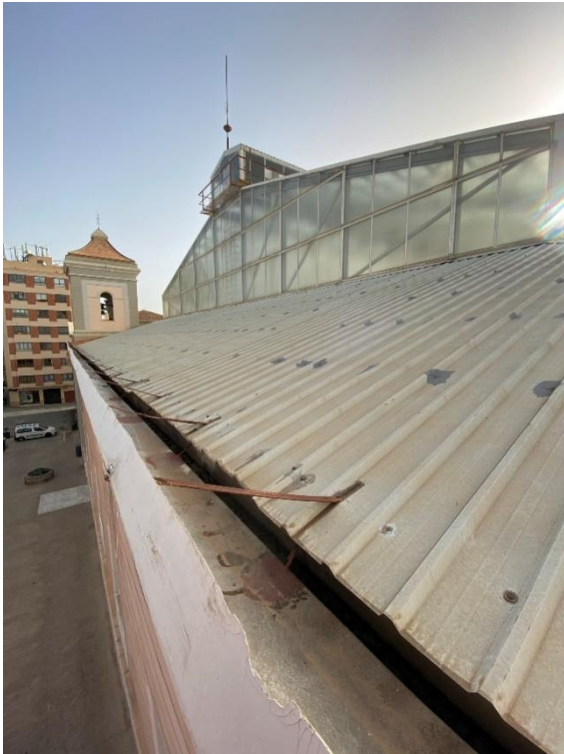
Fotografía de la cubierta y el canalón actual Fuente: El fabricante de esferas. 2021
