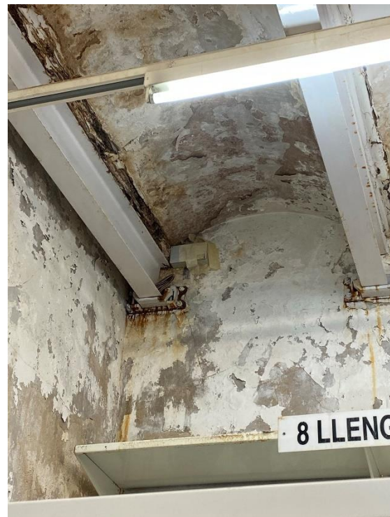
Fotografía del estado actual del forjado y los muros. Interior de la biblioteca Fuente: El fabricante de esferas. 2021
