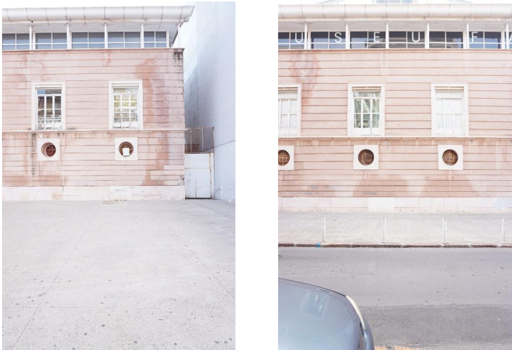
Fotografías de las humedades existentes en fachadas. Fuente: El fabricante de esferas. 2021
