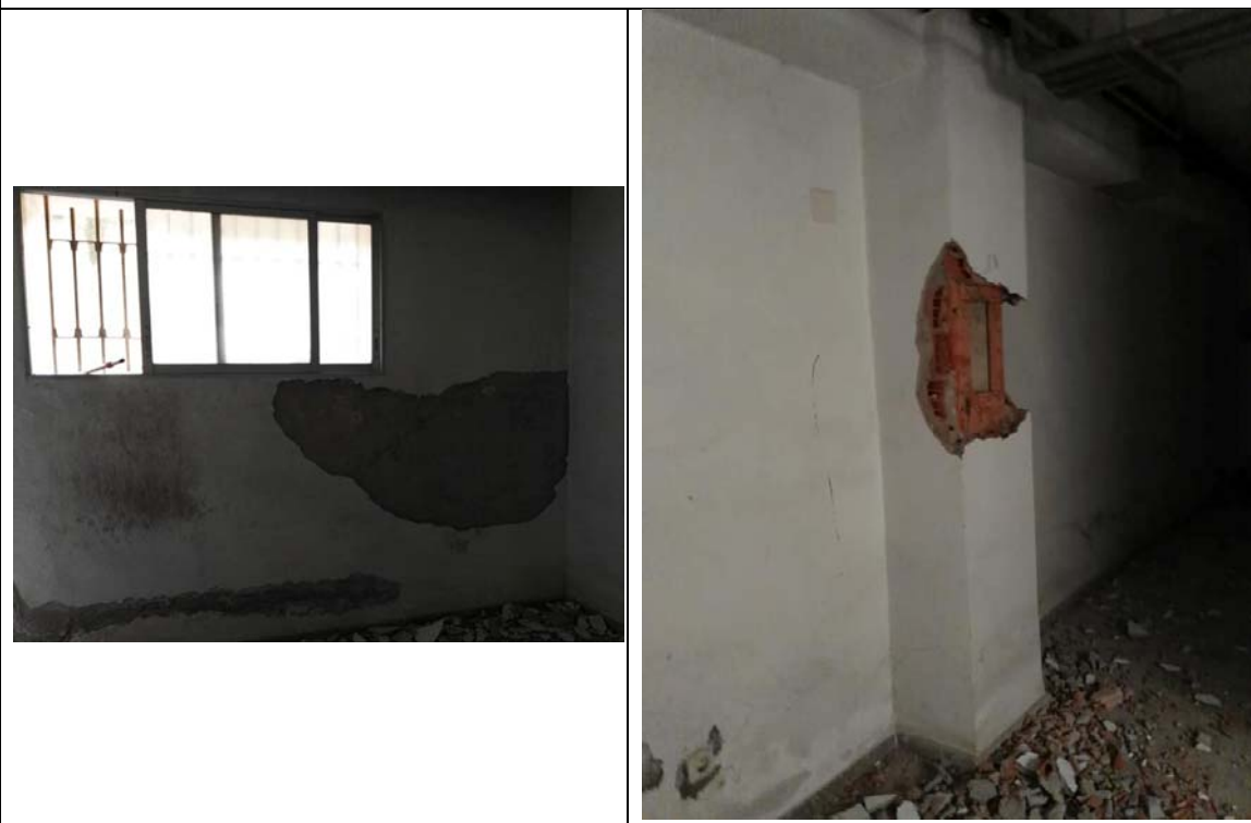
Vistas de distintos elementos resistentes ubicados en planta sótano (muro de hormigón perimetral y pilar)
