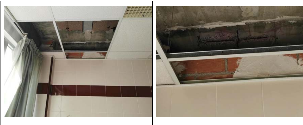
Detalles de entregas de viguetas en vigas y problemas de corrosión por falta de recubrimiento
