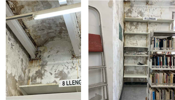
estado actual del forjado y paramentos del interior de la biblioteca
