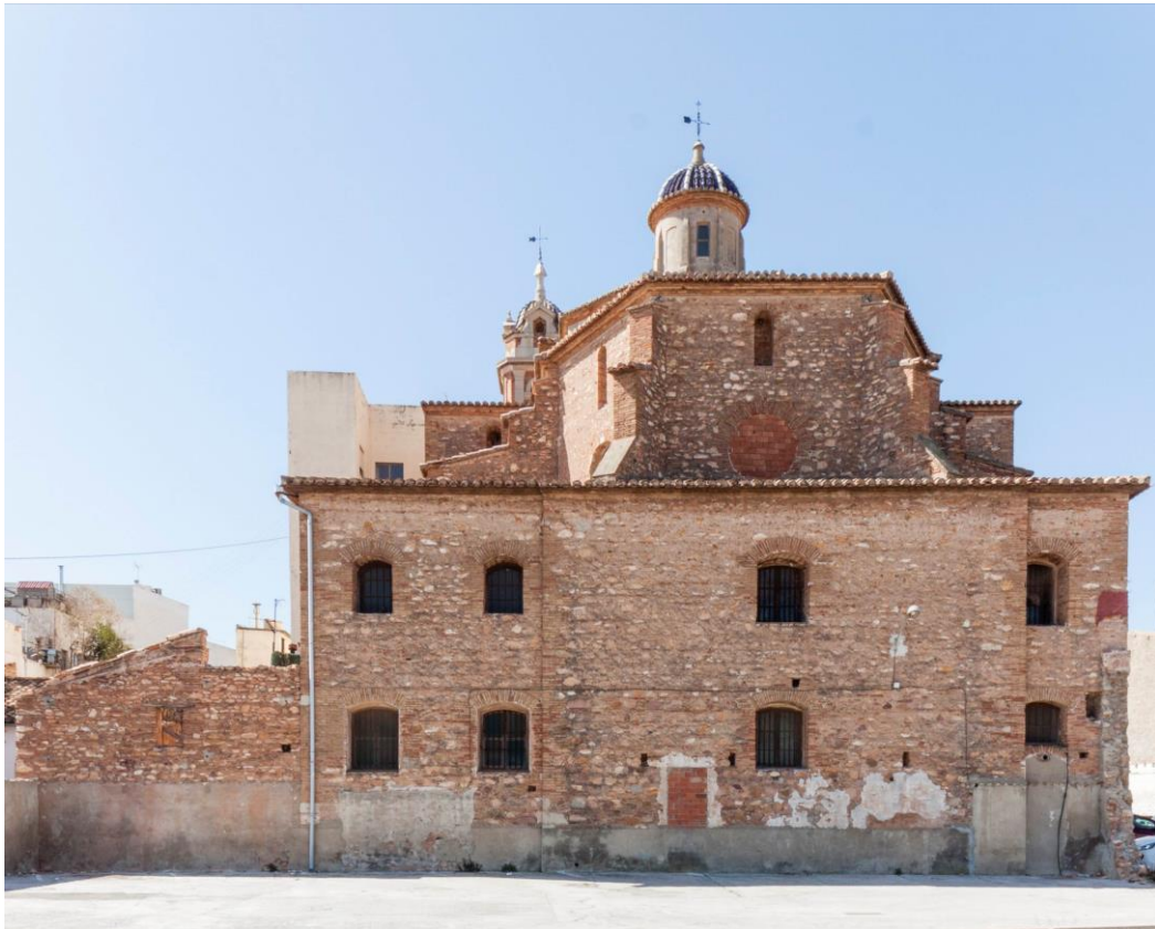
Estado de conservación de los muros de mampostería del alzado norte de la Iglesia de Sant Blai. En la imagen se puede ver erosión superficial, el cegado de huecos superiores y el zócalo de mortero de cemento entre otras lesiones.
