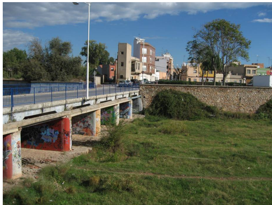
Imagen del puente sobre el río que conecta con la parte norte del casco urbano Se aprecian los grafitis en los muros del cauce
