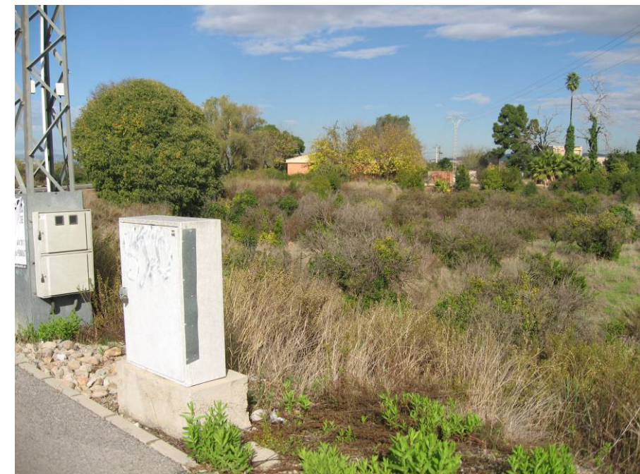
Elementos para infraestructura eléctrica situados al margen de las vías.
